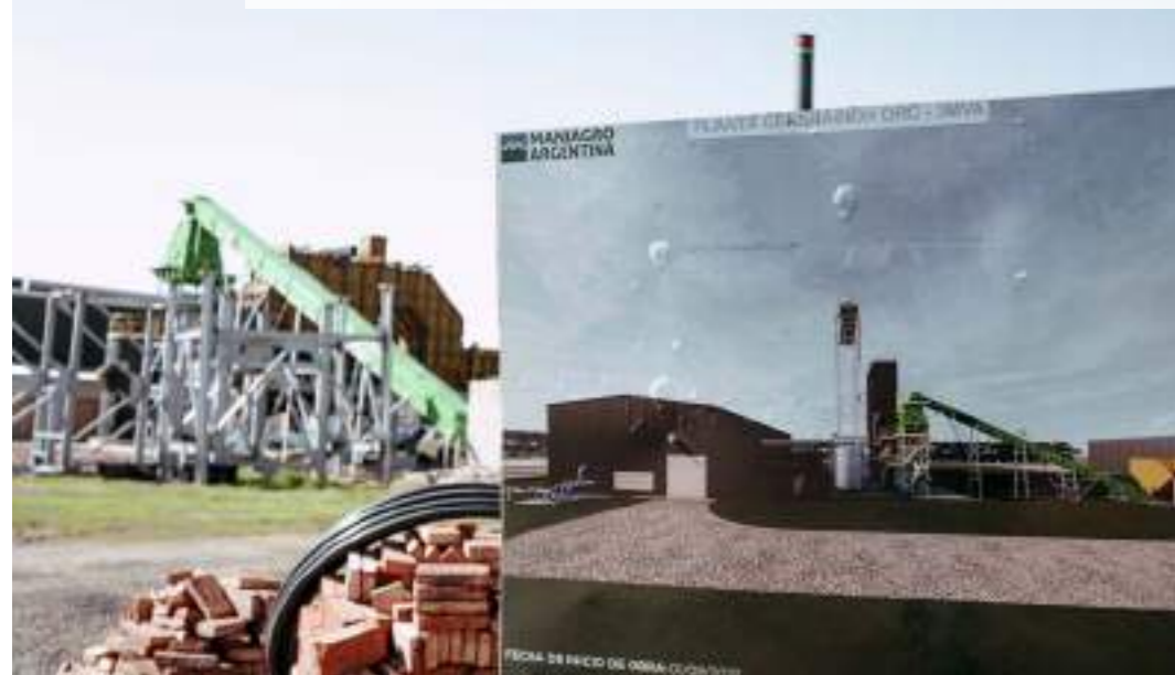
Planta de generación de energía a partir de biomasa
